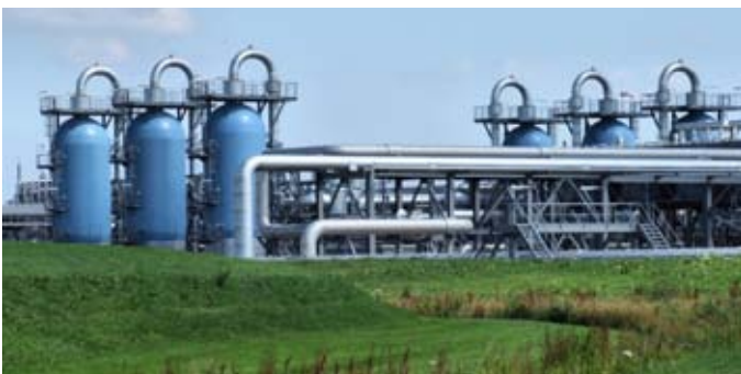
Gasopslag in Langeloo
